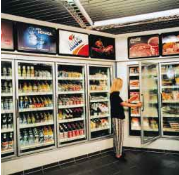
Der viertürige Getränkeköhlschrank und der zweitürige Tiefköhlschrank wurden in der Westfalen-Tankstelle Münster-Roxel neu installiert.
