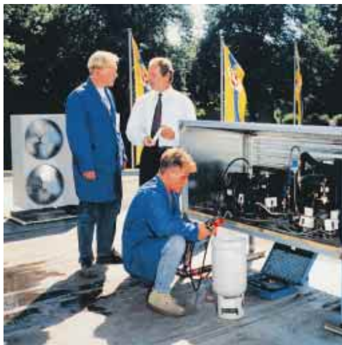
Franz-Josef Drieling (Mitte), Technischer Berater Kältemittel bei der Westfalen AG, berät die Monteure der Firma Herber & Petzel bei der Inbetriebnahme der Kältemaschinen auf dem Dach der Roxeler Tankstelle.
