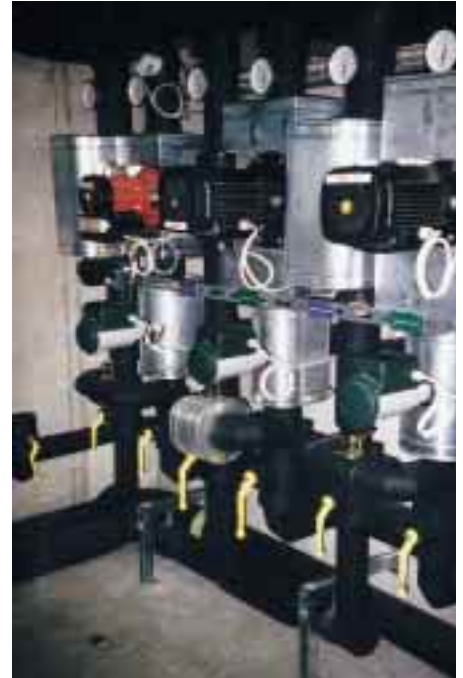
Eine Partie des Gruppenverteilers für das Flo-Ice.
