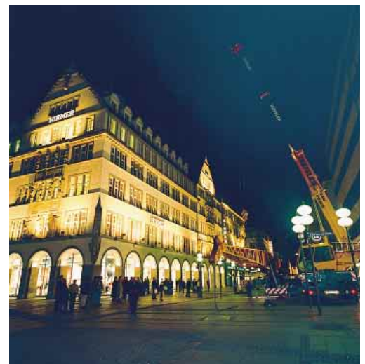
Nächtliche Schwerarbeit – das Aufstellen von Absorber und Kühlturm auf dem Kaufhausdach (Foto: Thermoplan).
