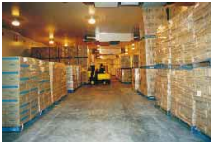
Die Kühlanlage im Kühlhauskomplex der Hafenbehörde von Albany, Westaustralien. (Foto: AlliedSignal, ASC/PR027).
