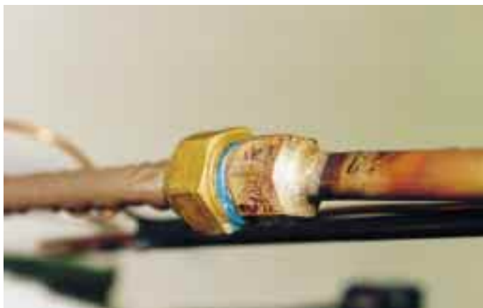
Abb. 2 Grünfärbung von einem nassen Messingteil infolge eines kleinen Lecks.
