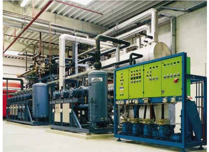
Linde-Kältezentrale eines Logistik Centers mit dem Kältemittel Ammoniak.
