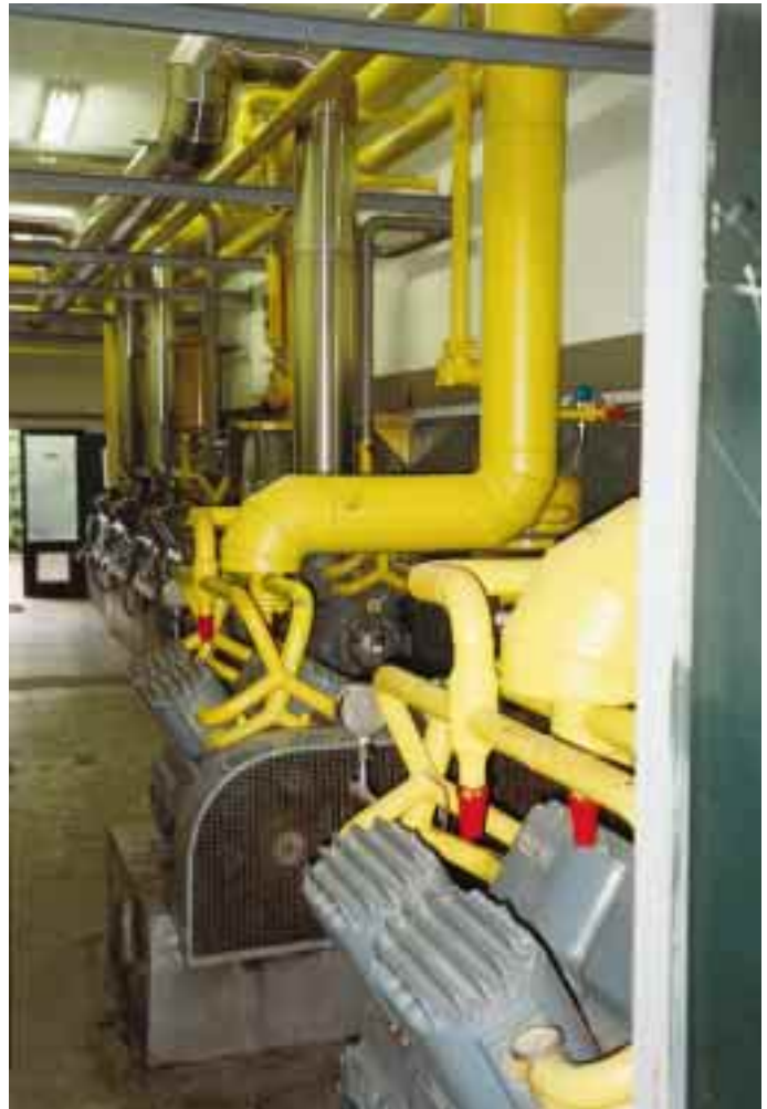
Teilansicht des neuen zentralen Maschinenraumes, der nun kurze Wege zwischen den Verdichtern (Fabrikat Witt) und den Verdunstungskühlern gestattet.
