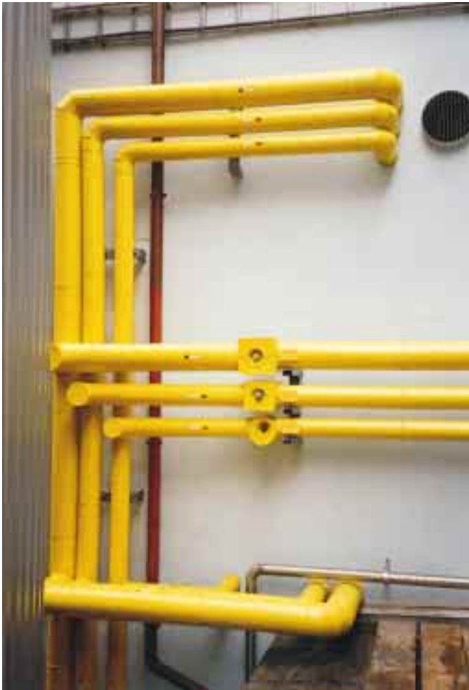
Neu verlegte Rohrleitungen mit vorschriftsmäßig angebrachter NH 3 -Fließrichtungs-Kennzeichnung.
