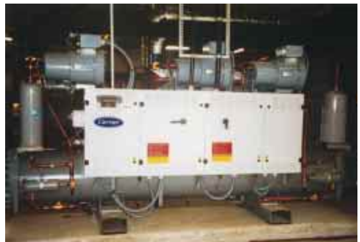
Im ehemaligen Staatsratsgebäude in Berlin, das jetzt die Bundesbau-direktion beherbergt, sorgt dieser wassergekühlte Global Chiller mit drei Schraubenkompressoren für Kühlung.
