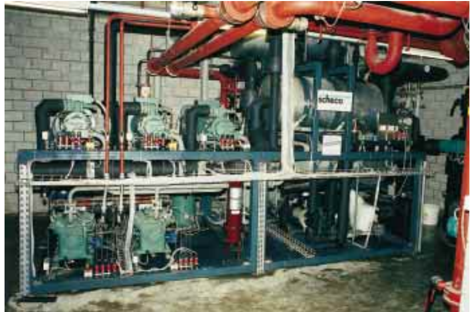
Teilsicht des Maschinenraumes im Coop-Center Schaffhausen, in dem erstmals im praktischen Betrieb CO 2 als Kälteträger für den Tiefkühlkreislauf eingesetzt wurde.
