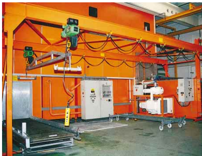
Innere Reinheit der Wärmetauscher und Umweltfreundlichkeit für den Standort sichert die KÜBA per Waschanlage.
