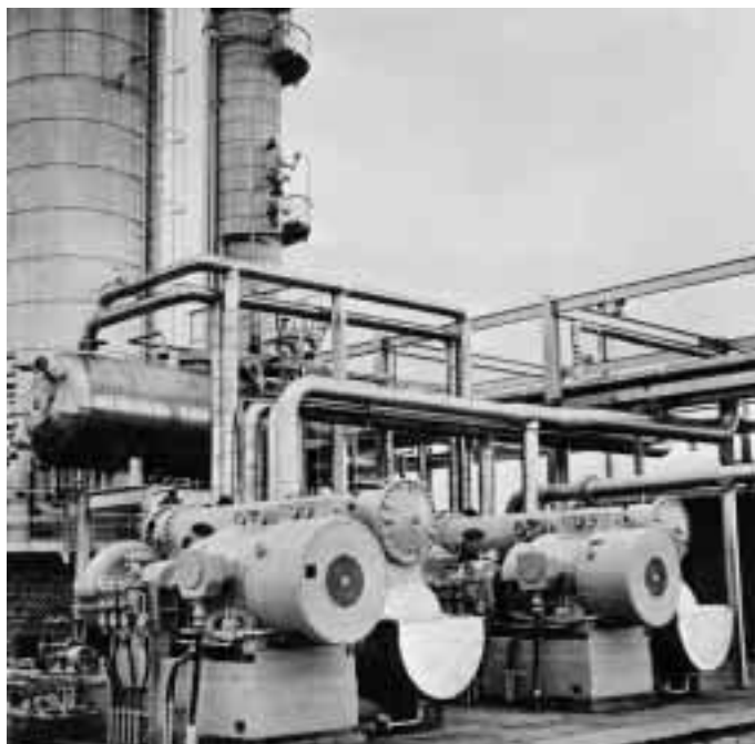
Abb. 11 Turbokälteanlage zur Verflüssigung von Erdgas in Kuwait.
