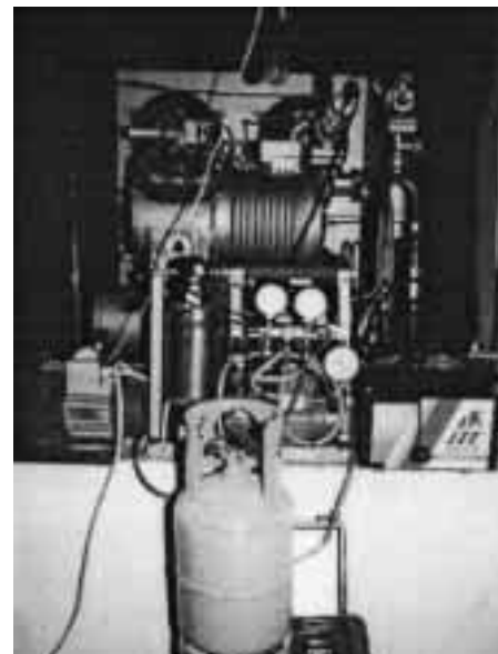
Abb. 5 Ovocentrum s.r.o. Košice an den Anlagen CHZP mit 25 kg Kältemittel R 12 ausgetauscht durch R 401A, R 409A.
