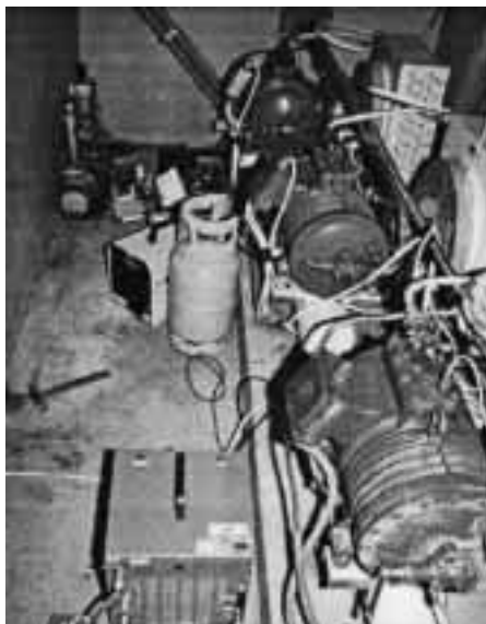
Abb. 4 VM Agromed a.s. Vefl 3 / 4 ký Meder an den Anlagen ZD6 mit Verdichtern KP 101 mit 13 kg Kältemittel R 12 ausgetauscht durch Kältemittel R 134a, R 404A, R 409A.
