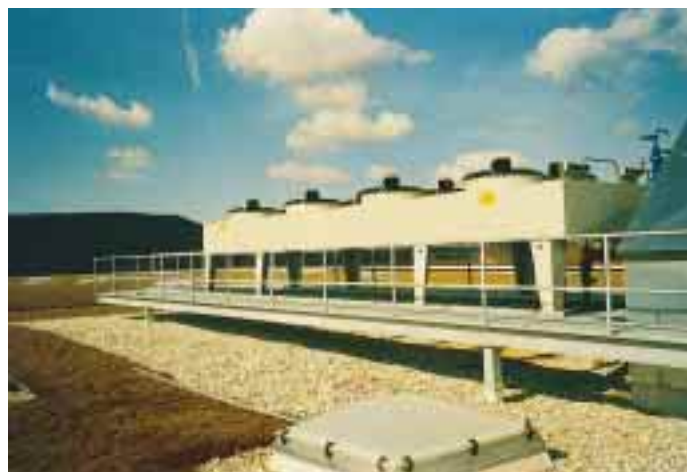
Erste Bilder des neuen Verflüssigers von Küba im Freilufteinsatz
