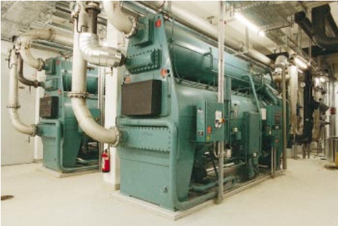
4 YORK Absorptionskältemaschinen mit einer Gesamtkälteleistung von 5700 kW sind in das Energiekonzept der neuen Messe München eingebunden
