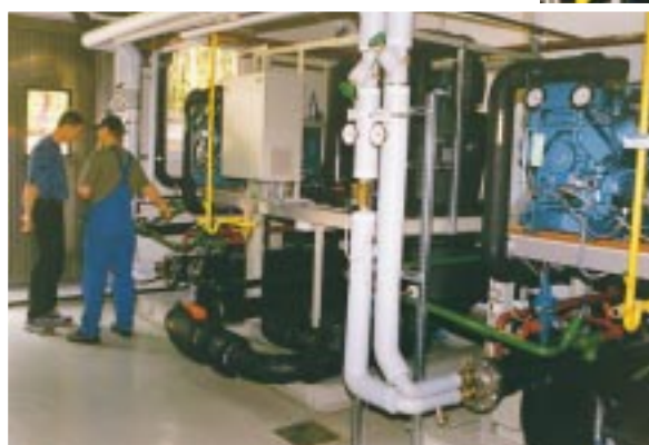
Blick in die Technikzentrale. AKÜ-Firmenchef Dipl.-Ing. Adolf Schmidt und seine Monteure haben eine vorbildliche Kälteanlage installiert ...
