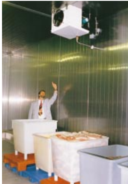
Pökelkühlraum. Kein Problem für den Kühlstellenwärmetauscher, wenn Rohre und Lamellen aus Edelstahl gefertigt sind. Darauf verweist hier Martin Törpe, Technischer Leiter der Hans Güntner GmbH, Fürstenfeldbruck
