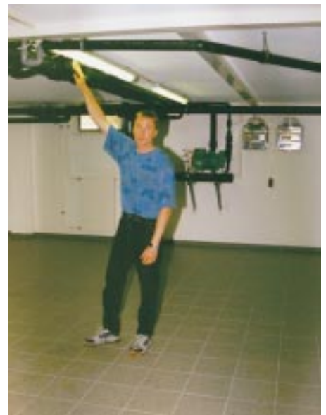
Isolierte Binäreis-Ringleitung unterhalb des Großhandels-Ladenverkaufsraumes. Jede Kühlstelle wird über eine eigene Kühlstellenpumpe versorgt. Im Hintergrund der R 404A-Bitzer-Verdichter für die Tiefkühltruhe. Binäreisgekühlter Verflüssiger
