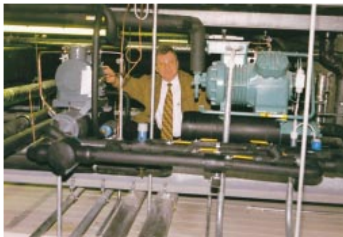
Die R 404A-Verdichter, Fabrikat Bitzer, für Tiefkühlraum und Scherbeneisbereiter sind im Zwischendeckenbereich über den Räucherammern positioniert
