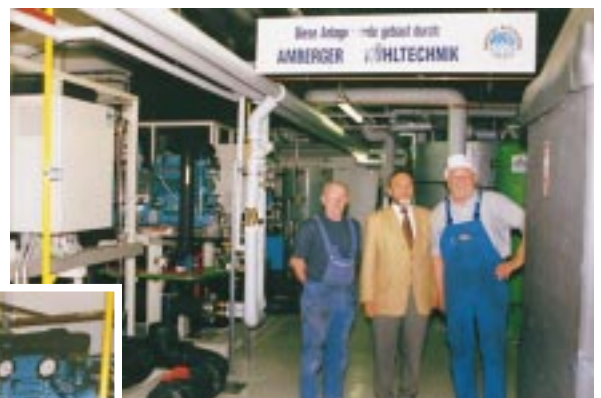
... Zwei Binäreisaggregate mit je einem direktgekoppelten NH 3 -Hubkolbenverdichter (Gesamtkälteleistung 230 kW, Füllvolumen 130 kg NH 3 je Kältekreislauf) decken die kältetechnische Versorgung von 35 Kühlstellen ab
