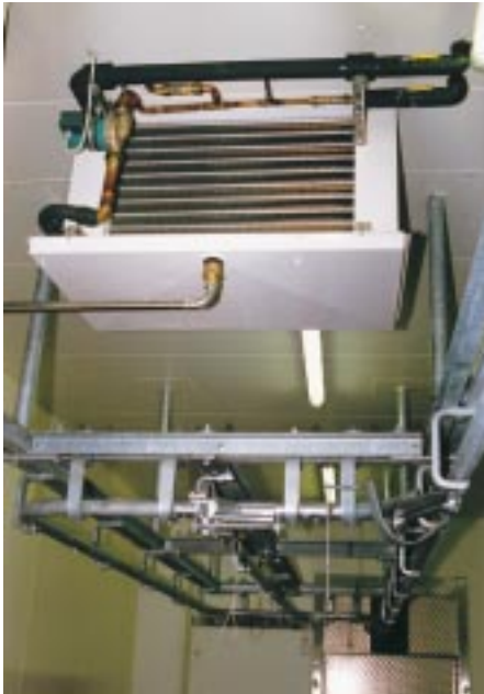
Ansicht der Rückseite des Kühlstellenwärmetauschers. Der Binäreisdurchfluß wird über die raumtemperaturgesteuerte Umwälzpumpe (hier Fabrikat WILO) exakt geregelt
