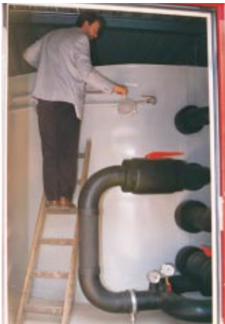
Funktionskontrolle des Binäreisspeichers. Der Speicher ist zweischalig gebaut und gegen Wärmeverluste isoliert. Die einzelnen Kühlstellen werden von hier aus über eine Ringleitung mit einem Talin-Corin-Wassergemisch (Binäreis) versorgt
