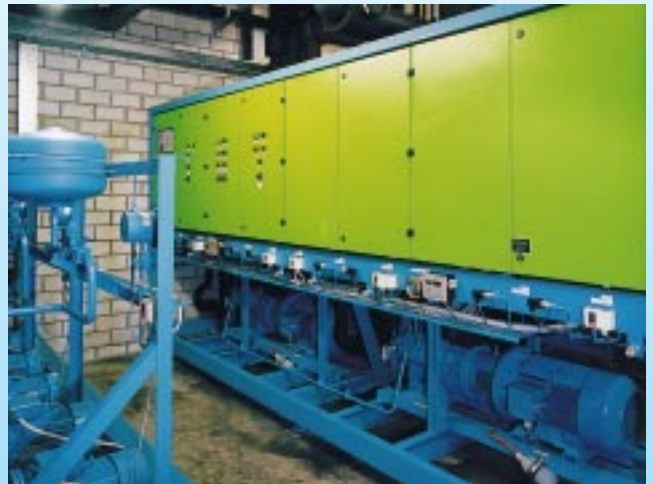
Tiefkühlsatz und Pumpenstation einer Ammoniak-Kälteanlage für Supermärkte 520
