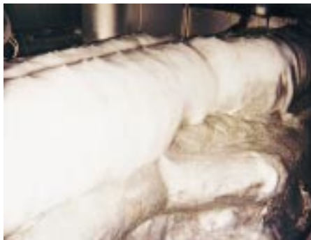
Vereiste „argentinische“ Rohrleitungen. Einlagig mit 50 mm alukaschierten Steinwollschalen „isoliert“
