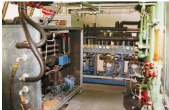
Das Herz der Forschungs- und Versuchsabteilung. Verdichter-, Heißgas-, Plattenverflüssiger-Module, Sammelbehälter, Rückkühler, Rekuperativ-Kalorimeter
