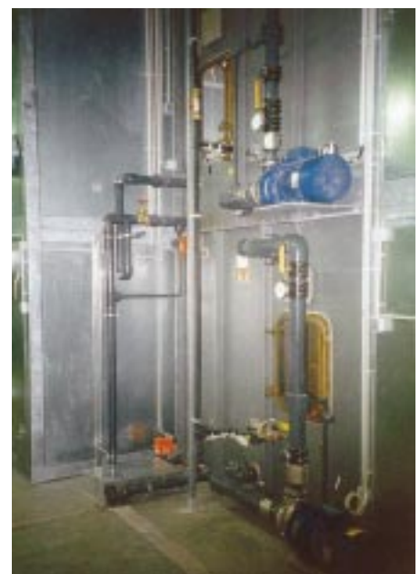
Die Pumpenstation für die DEC-Anlage
