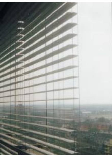
Die auf Befehl der Wetterstation aus verstellbaren Lamellenraffstores im Fassadenzwischenraum im geringen Abstand zur Einscheiben-Außenfassade
