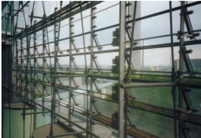
Verstellbare Außenluftfenster im Technikgeschoß
