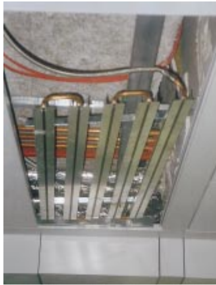
Ein Kühldeckenelement mit entfernter Deckenverkleidung und erkennbarem flexiblem Anschluß. Die Temperatur der Oberfläche der Metalldeckenverkleidung wird durch das Rohrleitungselement gekühlt und bewirkt durch Strahlungsaustausch ca. 60 % und durch Konvektion ca. 40% der Aufnahme der Wärmelast
