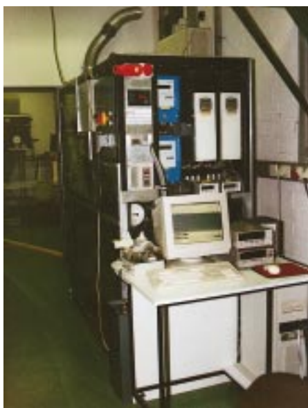
Aktuelle Forschung im Bereich der Kältetechnik am Institut in Essen: Versuche mit einer Kaltdampfkomppressionskälteanlage in Kaskadenschaltung mit dem Arbeitsstoffpaar R 290/R 744 (Propan/CO 2 )
