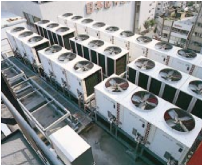
Abb. 3 Großgebäude mit Multisplitanlage (Werkbild Sanyo)
