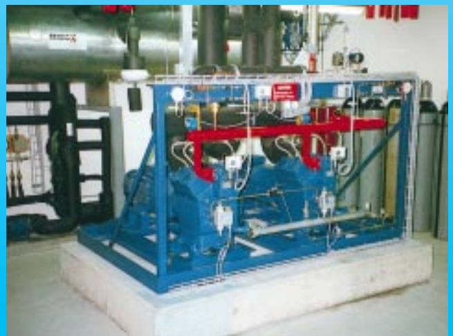
CO 2 als Kälte­träger für die Tiefkühlung
