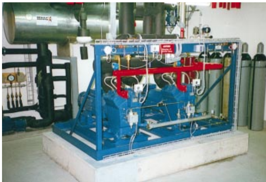
Bild 1 Kälteerzeugung für die Tiefkühlung mit zwei Kolbenverdichtern (Fabrikat Bock); Links oben im Bild der CO 2 -Sammelbehälter und rechts außen die Nachfüllflaschen mit der CO 2 -Füllung
