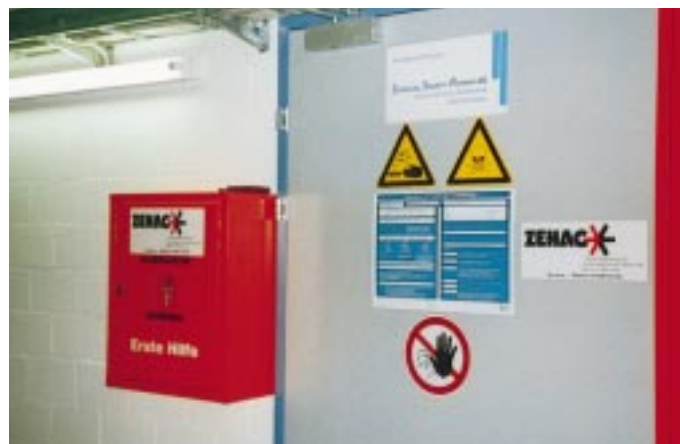
Bild 7 Augendusche (rot) und Anschlag über Verhaltensmaßnahmen an der Eingangstür zu den technischen Räumen
