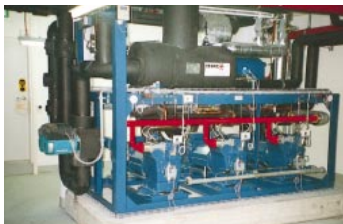
Bild 4 Kälteerzeugung für die Normkühlung mit drei Kolbenverdichtern (Fabrikat Bock)
