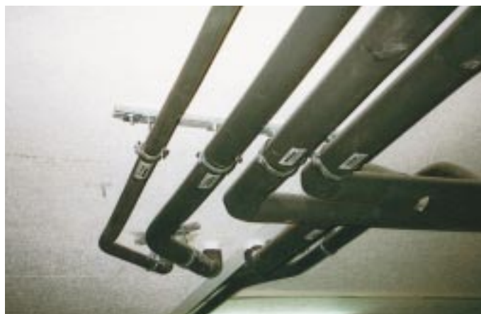
Bild 3 Vergleich der Leitungsquerschnitt. Links Vor- und Rücklaufleitung für das Antifrogen N der Normkühlung und rechts Vorlaufleitung (ganz rechts) und Rücklaufleitung CO 2 für die Tiefkühlung
