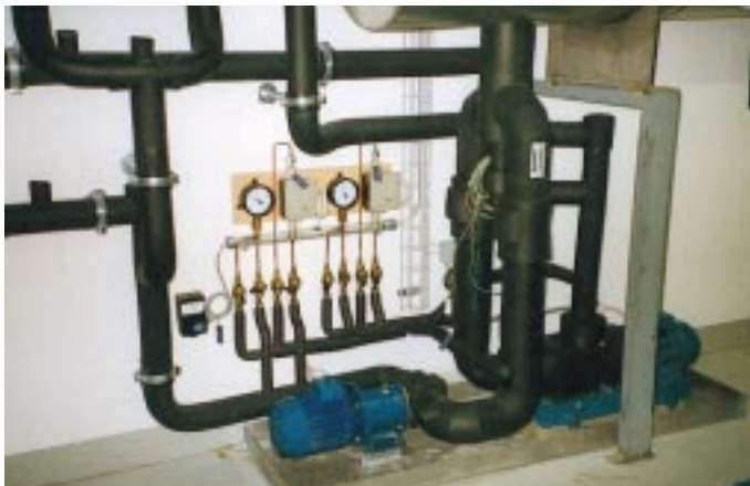
Bild 2 Pumpengruppe mit Zahnradpumpe (links) und Seitenkanalpumpe (rechts)
