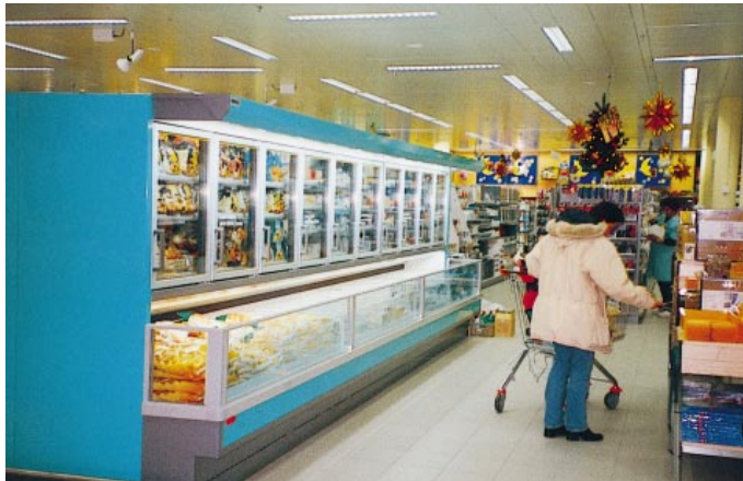
Bild 5 Eines der Tiefkühlregale (Fabrikat Linde)
