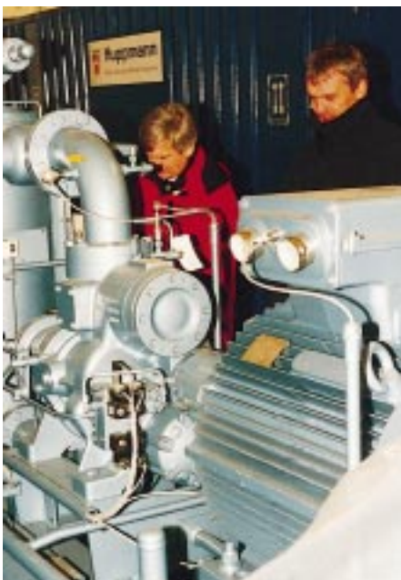
Ein NH 3 -Kältesatz steht versandbereit vor dem Container. Wo Huppmann draufsteht, ist manchmal auch GEA Grasso drin
