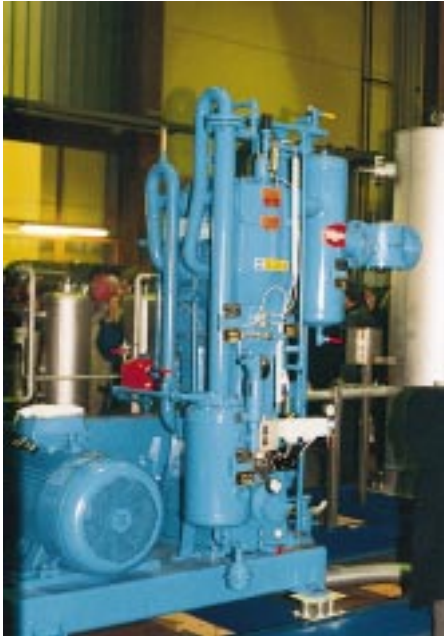
Die CO 2 -Rückgewinnungsanlage wird zusammengestellt und geprüft. Der Verdichterteil stammt von der traditionellen Zulieferfirma MEHRER in Balingen
