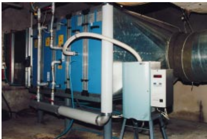
Eine der 6 Klimazentralen in den niedrigen Kellerräumen des Wilanow-Palastes
