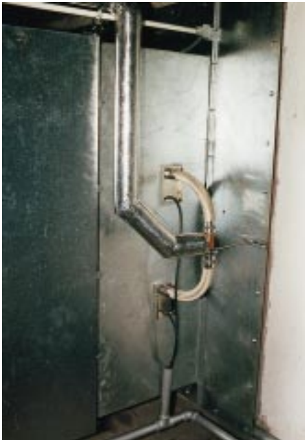
Detail der Dampfzuführung und Verteilung auf die beiden übereinander angeordneten Dampfverteiler-Rohre, Kondensatabführung über Schlauch mit freiem Einlauf
