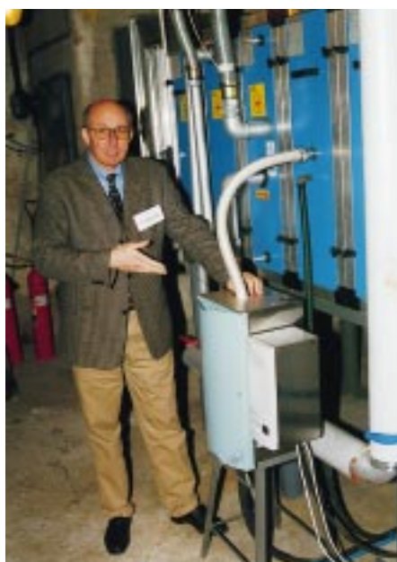
Konstrukteur Jacques Nordmann erklärt. Hier wird der Dampf direkt über Schlauch in das Kompaktklimagerät hineingeführt. Darunter sichtbar die Kondensatableitung über Schlauch
