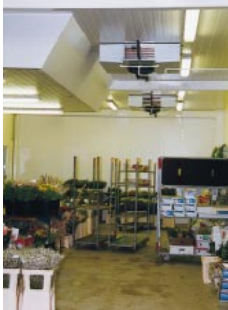
Alle Verkaufskühlräume sind mit für Sole-durchfluß geeigneten Deckenluftkühlern des Fabrikates Küba ausgestattet. Diese sind zug-, entfeuchtungs- und geräuscharm
