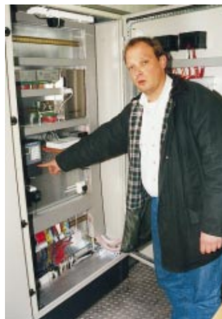
Kältecontracting. Mit dem hier von Kälteanlagenbauermeister Bernd Ruffer in seiner Funktion erklärten M-BUS-ZE wird der Energieverbrauch der gesamten Kälteanlage erfaßt
