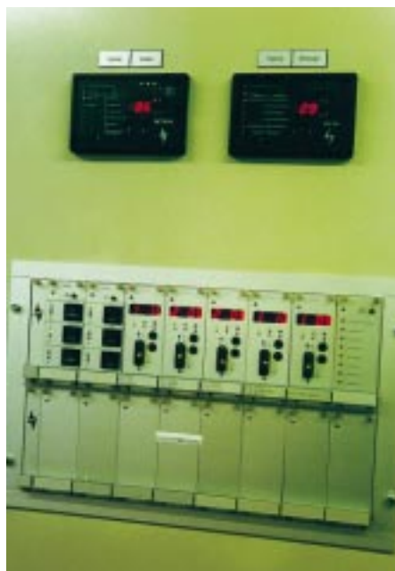
Die Fernüberwachung erfolgt über das Wurm-Regelungssystem Frigodata
