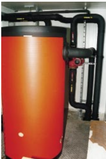
Zwischen 20 Uhr und 2 Uhr nachts wird ein 1500-Liter-Latentspeicher (Fabrikat BMS) beladen. Die Entladung erfolgt erst ab 10 Uhr, wenn die Markt-Verkaufszeit beendet ist
