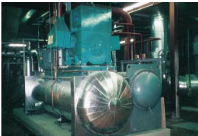
YORK-Turbo- kaltwassersatz: sichtbar Verdampfer, Verflüssiger und Hochspannungsmotor
