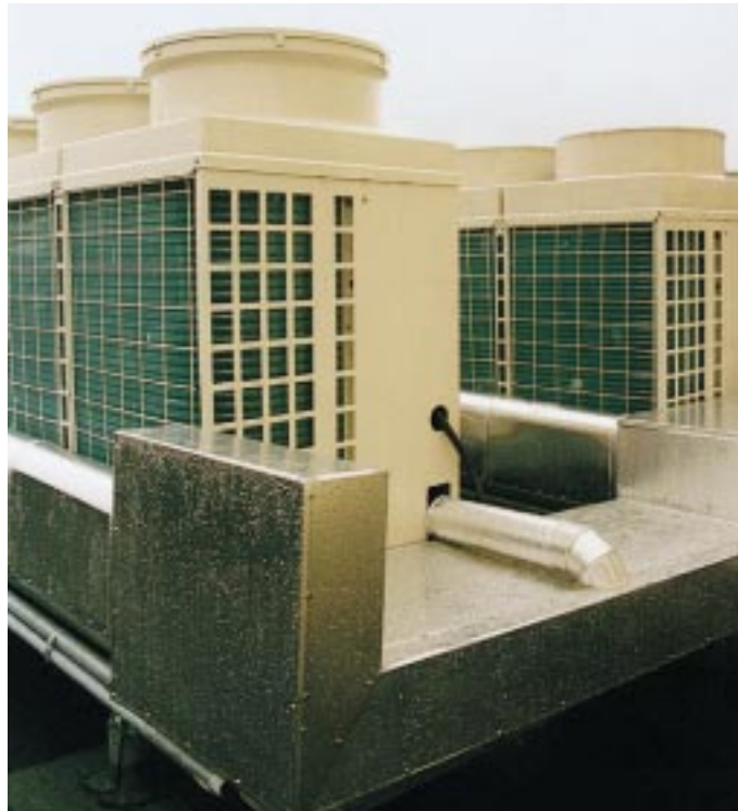
Bild 5 Elegante Verkleidung der Kältemittelleitungen
