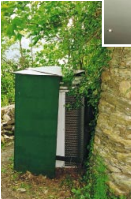
Außen ein „unsichtbar“ installierter Verflüssiger
