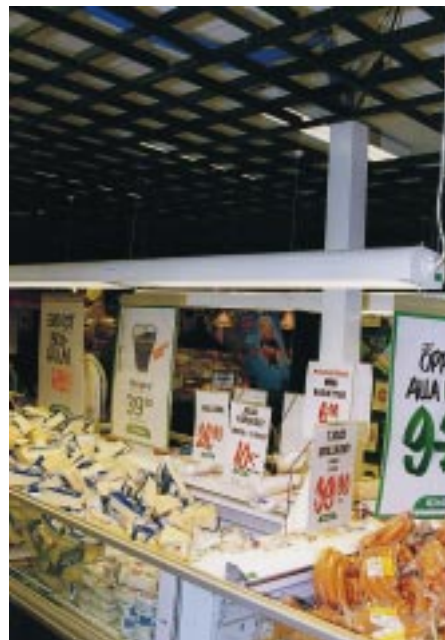
Viel Flexibilität bei Kühl- und Tiefkühlinseln. Eingebaute R 404A-Maschinensätze mit Temper 20/Temper 40 Kälte-trägerkreislauf ermöglichen eine rasche Aufstellungsveränderung. Aus und in die Zwischendecke führt ein durch Bleche senkrecht verblendeter Kaltwasserkreislauf zu einem im oberen Gebäudebereich aufgestellten Chiller
