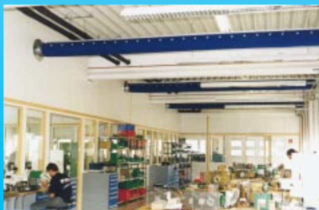
Textilbasierte Lüftung in der Industrie
