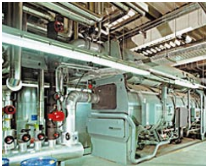
Zunehmend kommen Absorptionskälteanlagen zum Einsatz, die kühlen und auch heizen können
