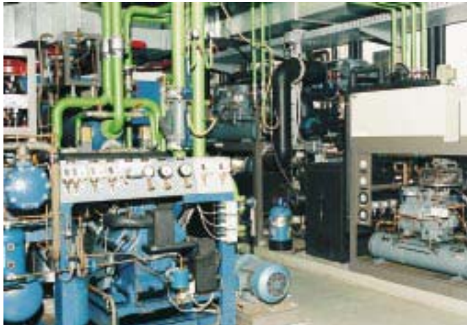
Bild 2 Teilansicht der von der Firma Weiss Umwelttechnik in der Wehrtechnischen Dienststelle Meppen für die Klimasimulationskammern installierten Kälteanlagen
