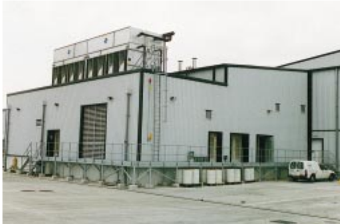
Verdunstungskühler von Baltimore Aircoil Typ VXC1124 auf dem abgesenkten Dach der Technikzentrale
