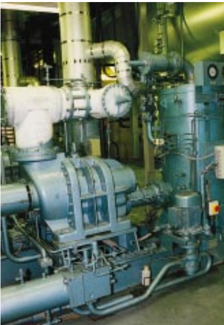
Teilansicht der Maschinenanlage mit dem Grasso-Schraubenverdichter Typ V, Förder­volumen 1648 m 3 /h
