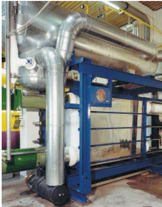
Der neue Thermo-wave-Plattenwärmeübertrager im Einsatz
