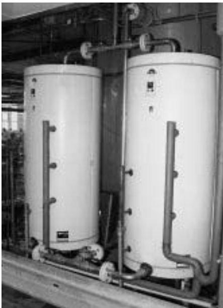
Das Permanent-Transfer-System im Duo produziert in einer Hotel-Anlage in Singapur pro Stunde 1800 Liter Warmwasser von 65 °C
