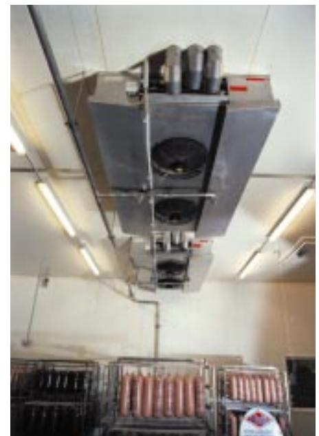
Bild 4 Luftkühler in einem fleischverarbeitenden Betrieb
