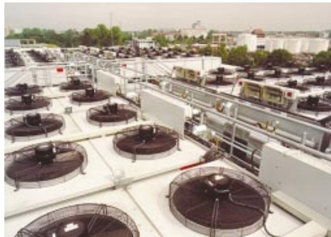
Bild 3 Rückkühleranlage für eine EDV-Klimatisierung
