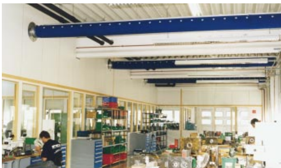
Durch das textilbasierte Luftverteilssystem, hier der Niedrig-Impulsschlauch von KE-Fibertec, wird die Luft zugfrei und gleichmäßig in den Raum eingeblasen
