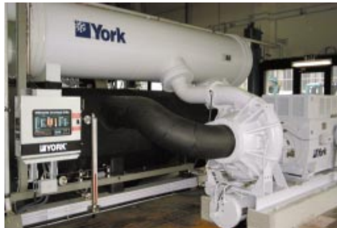
Der von YORK umgebaute Turbokaltwassersatz auf der Messe Berlin
