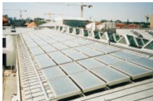
Hier wird die Energie für die Absorptionskältemaschine erzeugt
