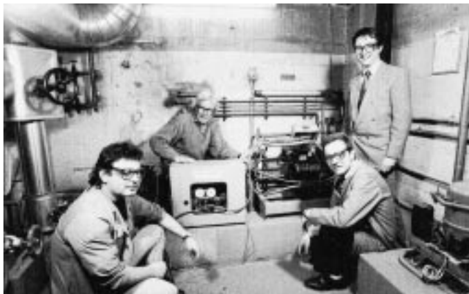
Umrüstung einer FCKW 12-Anlage mit SUVA® 134a am Kantonkrankenhaus Genf 1993
