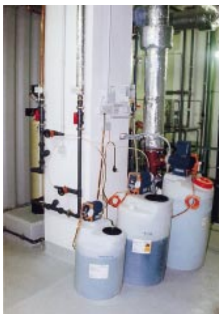
Normalerweise kann für die Dampf- luftbefeuchtung reines Leitungswasser verwendet werden. Nicht so im Semperbau. Hier wurde vorsorglich noch eine Wasseraufbereitung vorgeschaltet
