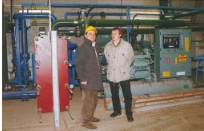
ATK-Geschäftsführer Gerald Günzl und Projektingenieur Norbert Braumann vor einem der beiden Flüssigkeitskühler mit insgesamt 1 MW für die Kaltwasserversorgung der Schachtanlage
