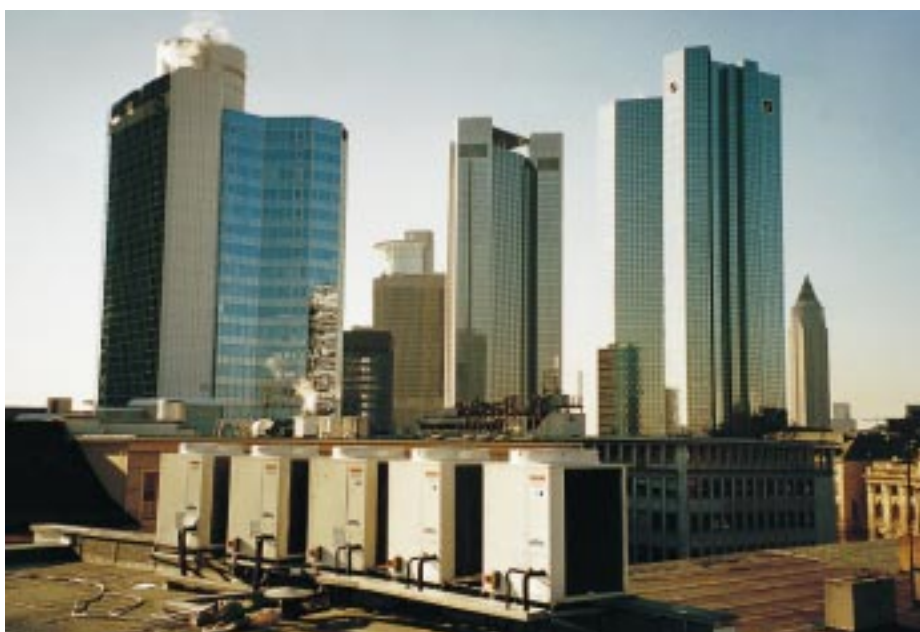
Bild 1 Ausgeführte SANYO-VRF-Multisplitanlage mit 5 Außeneinheiten (Heizleistung 162,5 kW, Kühlleistung 150,5 kW); BV Dow Jones Frankfurt/Main
