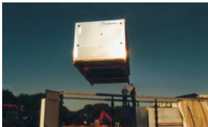
Zwei Climaveneta-Kaltwassersätze bei der Anlieferung für den Global Crossing Netzknoten in Hamburg
