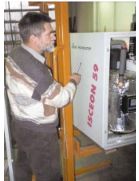
Keine Änderung am bisherigen R 22-Produktdesign. Die König-Wärmepumpe, hier kurz vor der Auslieferung auf dem Prüfstand, verfügt auch mit dem Kältemittel ISCEON 59 (künftig R 417A) und seiner Mineralölverträglichkeit über einen sehr guten Wirkungsgrad
