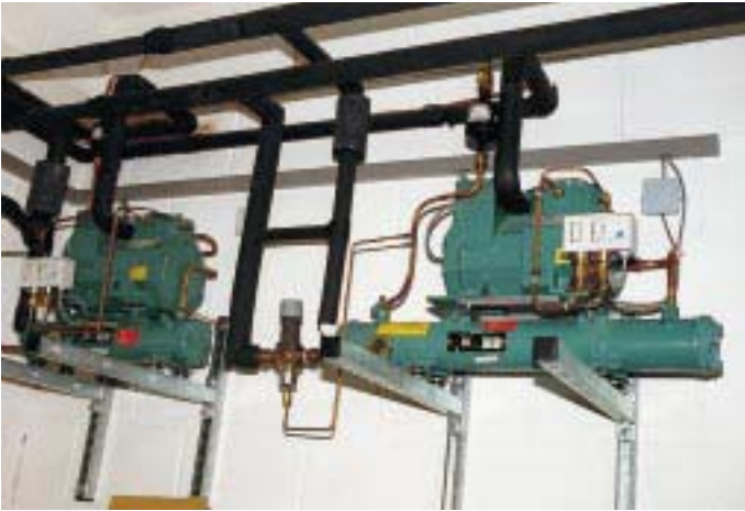
Binäreisgekühlte Verdichteraggregate (Fabrikat Bitzer) dienen der Direktexpansion von Tiefkühlraum, Kühlregal und Tiefkühlschrank
