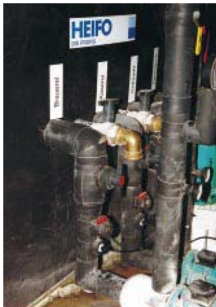
Direkt am Binäreisspeicher angebaut sind die Vor- und Rücklaufleitungen zu den einzelnen Hauptverbrauchergruppen
