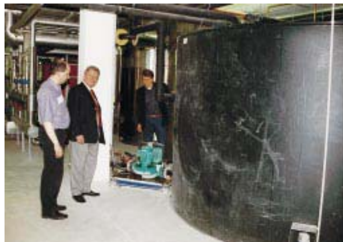
Binäreispeicher mit einem Volumen von 17 m 3 . Ein Blick ins Innere zeigt es: Kein falscher Schaum – sondern pumpfähiges Binäreis mit Rührwerk. Mit einem speziellen Filter wird ein Ansaugen der Eiskristalle zum Binäreiserzeuger verhindert
