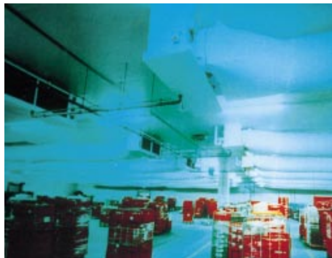
Luftkühler der Baureihe GHN mit Luftverteilerschläuchen aus Textilgewebe in einem Kühlraum-Verteilerlager
