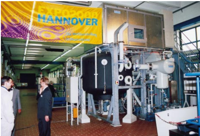
Ein EXPO-Projekt in Schleswig-Holstein: Vakuumeis-Erzeugungsmaschine von INTEGRAL mit Wasser als Kältemittel
