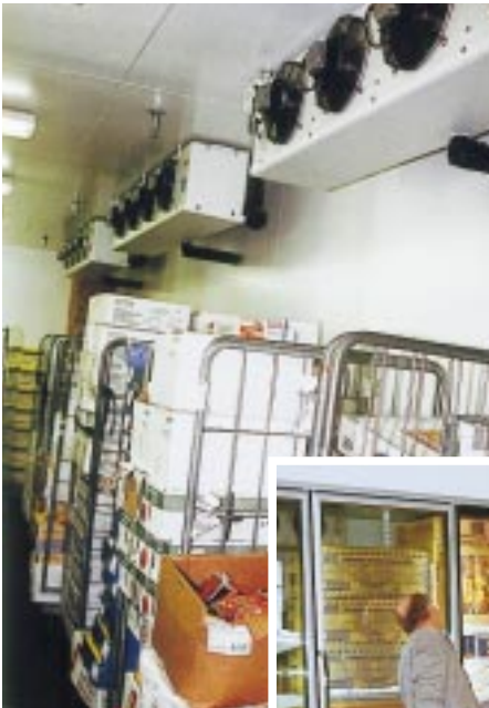
In der Längsfront des Tiefkühlraumes ist ein 10türiger verglaster Tiefkühlschrank integriert. Zwangsbelüftung des Bodens. Ing. Ben G. J. Ernens zeigt hier auf das Luftaustrittsgitter
