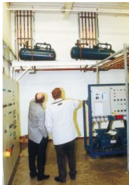
Die Flüssigkeitsbehälter sind im Bereich der Decke und mit einem Neigungswinkel von 10° positioniert. Dies ermöglicht eine optimale Kältemittelbefüllung der Anlage
