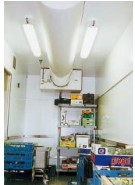
Sanfte Luftverteilung des Ventilatorluftkühlers Typ SGB 81 (Fabrikat Küba) über Textilschläuche im Obst- und Gemüse Kühlraum mit 44 m 3 Rauminhalt
