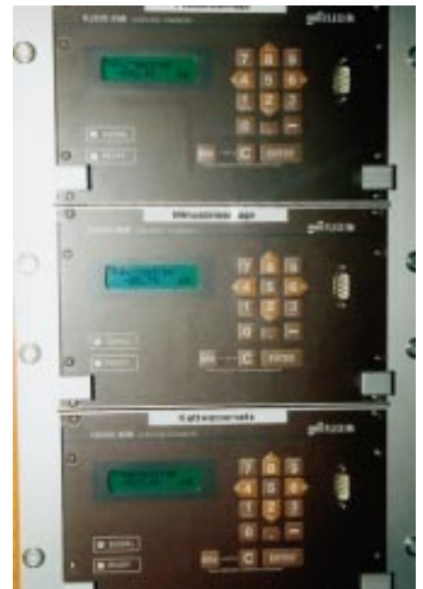
Können stolz auf die geleistete Arbeit sein. Die P & P-Verantwortlichen vor einem der riesigen Schaltschränke (v. r. Reinhard Prause, bauleitender Monteur Reinhard Möschter und Projektleiter Dieter Dannhauer). Darin eingebaut zeigen Leistungszähler den gerade aktuell abgegriffenen Kältebedarf
