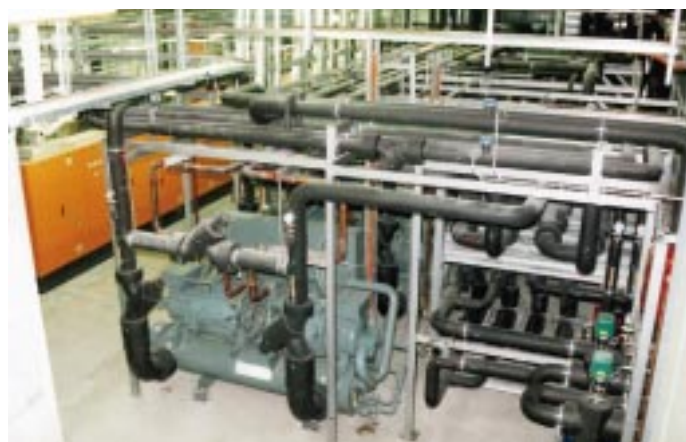
2 York-Kaltwasser-sätze (Kälteleistung insgesamt 630 kW) mit je zwei Hubkol-benverdichter (Kälte-mittel R 407C) wur-den zur Versorgung der Klimakälte auf-gestellt
