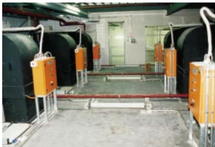
Eine der 11 Shuttle-Gruppen mit Radiallüfter-Verdampfer (Küba) und Luftverteilungssystem als Monoblock am Kopf der 20 m hohen Shuttle
