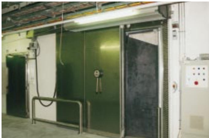
Dort, wo keine Kühlraumschleusen vorhanden sind, verhindern nicht nur durchsichtige Plastiktüren, sondern zusätzlich eine Luftschleieranlage (Teddington) oberhalb der Schiebetür einen Wärmeeinfall in den Tiefkühlraum
