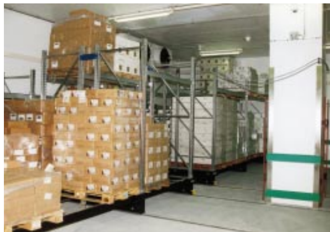
Auch die Tiefkühlräume (hier mit Schieberegalen) sind an einen Kaltsolekreislauf (bis -31 °C) angeschlossen und über 3 Geschoßebenen verteilt
