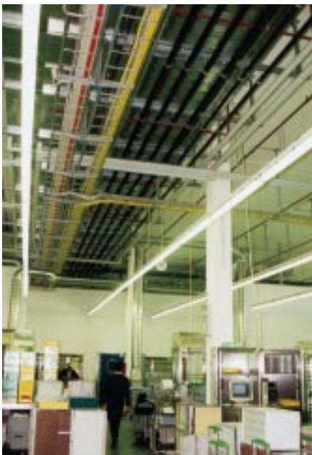
Pumpengestell für Plus- und Minus-Solepumpen (oben). P & P-Trassenführung (Kaltwasser, Plus- und Minussole) durch das Gebäude. Alles aus Cu-Rohr, mit Armaflex isoliert
