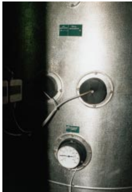
Solespeicher 2000 Liter von DK mit Rohrbündelverdampfer für die Minussole. Die Temperaturanzeige weist eindeutig -30 °C aus
