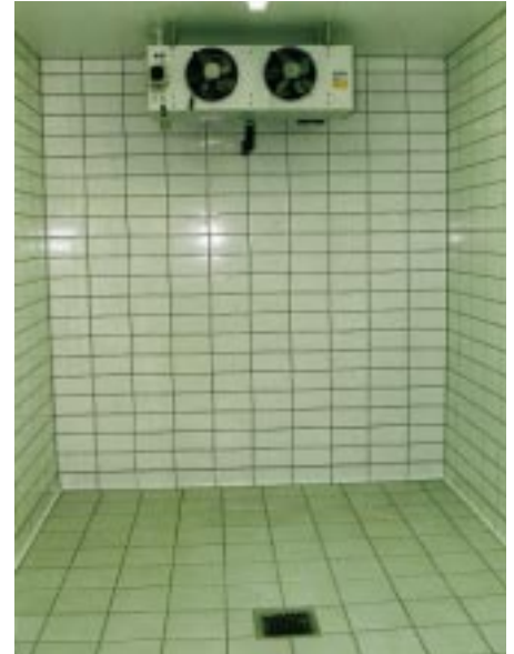
Der Abfallkühlraum wurde aus Hygienegründen zur optimalen Reinigung gefliest
