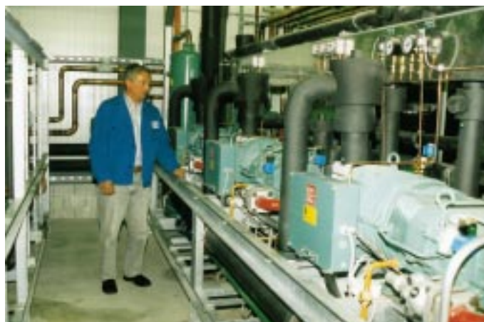
2 Plus- und 1 Minusverbundsystem mit Schraubenverdichtern von Bitzer (Kältemittel R 404A) wurden im 3. Obergeschoß zentral für die Solekühlung (2 × 400 kW und 1 × 170 kW Kälteleistung) aufgestellt
