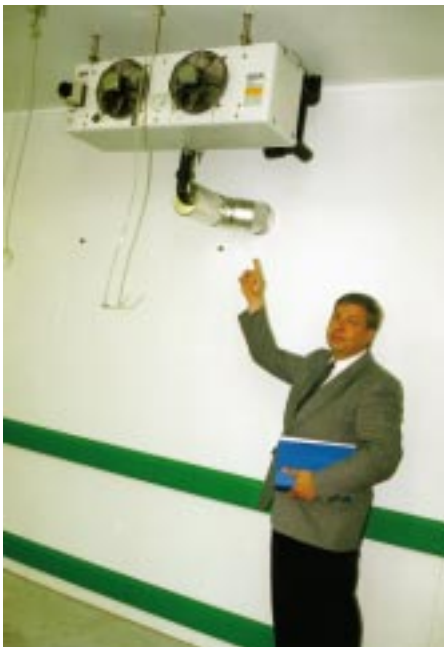
Brandschutzausführung der Tauwasserleitung durch eine Kühlraum-Brandschutzwand
